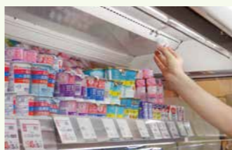
冷蔵庫内に設置した温度管理センサー
